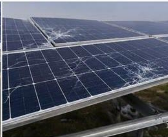
3. 组件出现裂纹或玻璃破损
