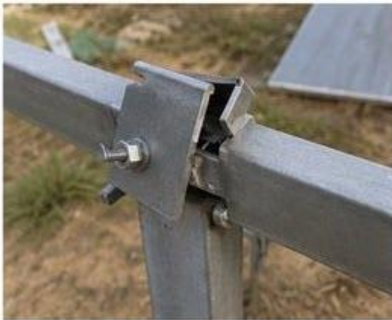
1. 结构零件（支架/压块）局部变形或断裂
