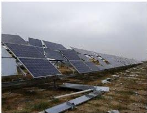
5. 整排组件受损，支架结构受力失衡
